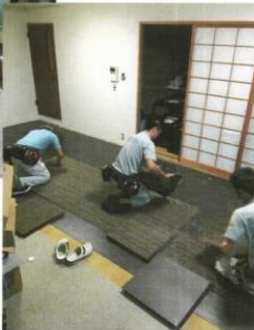
床施工 アンダーレイNT-4 + NT305V (リビング流し貼り、洋間市松貼り)
